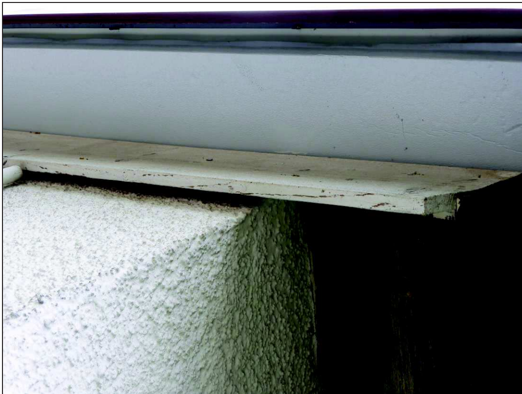
Abb. 4: Unbenutzter Spaltraum unter Giebelbrett an Gebäude Nr. 18
