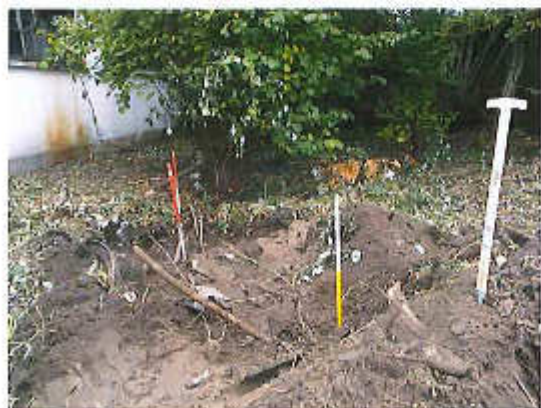
Foto 6 Suchscharf mit Freilegung der Kraftstoffleitung.
