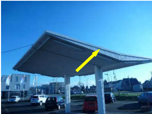
Abb. 7: Weiteres Dach mit Drempelblechabdeckung und potenzieller Eignung als Fledermauslebensstätte (8)
