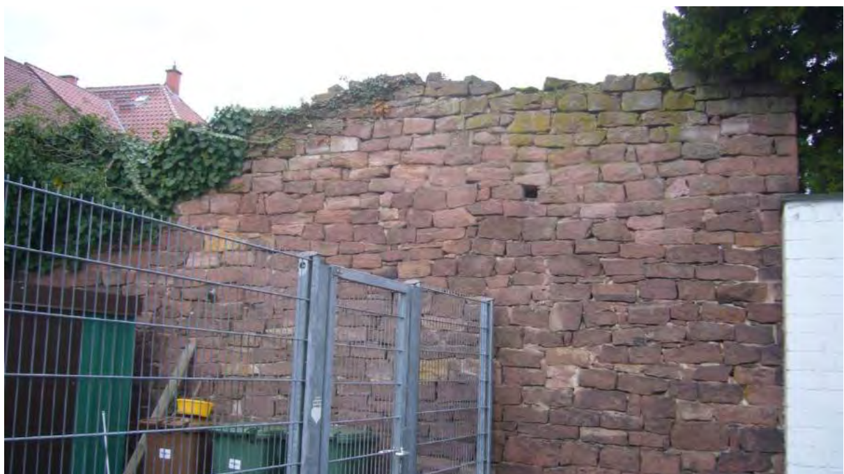
Foto 2 Sandsteinmauer mit offenen Fugen am südlichen Rand des Geltungsbereichs
