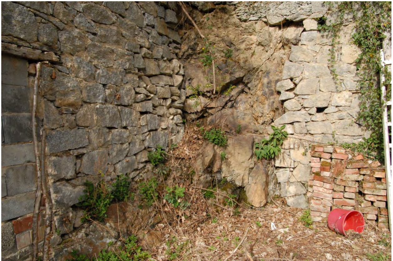
Foto 5 Spalten im Natursteinmauerwerk
