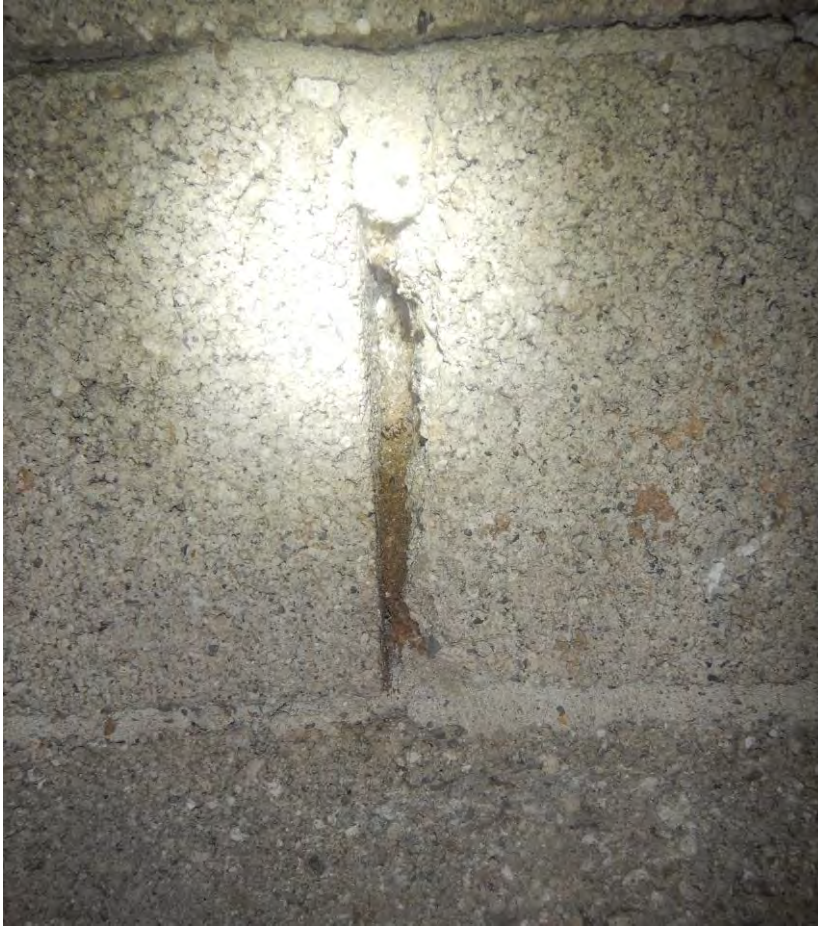
Abb. 5: Defekter Hohlblockstein mit Nistmaterial.
